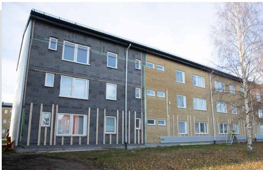
Under hösten har arbetet med att klä fasaden på Näsbyn 25J pågått.
